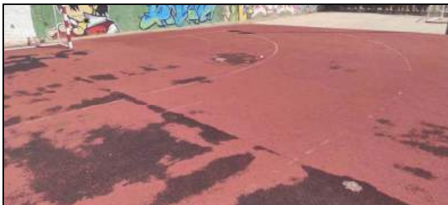
Fotografía 4: Detalle de deterioro.
